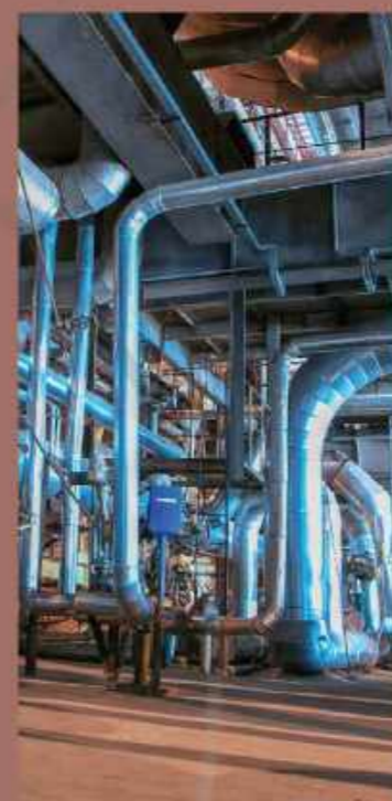
سیستم سرمایش و گرمایش برج
