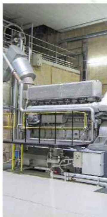
سیستم برق اضطراری
